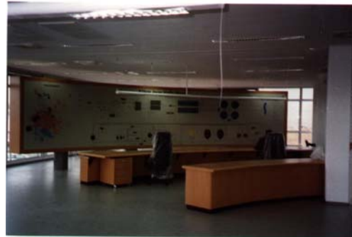
Kläranlage Halle / Sewage Treatment Halle (Germany)
