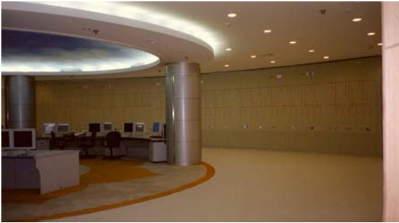
Leitwarte Drei Schluchten Staudamm China Central Control Room THREE - GORGES Hydropower Plant China
